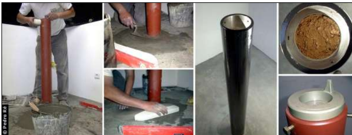
Figura 3- Pilar instalado no interior de um observatório.
